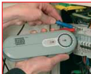
Photo prise sur installation consignée hors tension.
